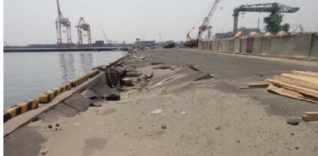
液状化対策未実施部分
