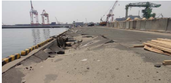
液状化対策未実施部分
