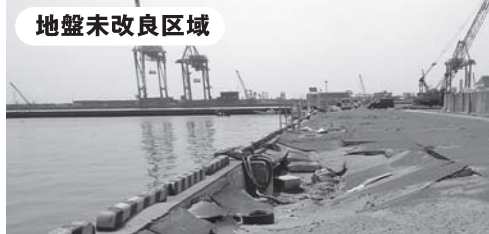
地盤未改良区域 仙台釜釜港未改良区域: 地盤改良が未実施 であり、地震後陥没が確認された。 (撮影:平成23年4月)
