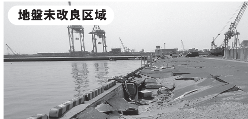
仙台塩釜港未改良域:地盤改良が未実施であり、地震後陥没が確認された。 (撮影:平成23年4月)
