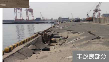
▲ 仙台塩釜港 未改良域：地盤改良が未実施 であり、地震後陥没が確認された。 (撮影：2011年4月)
